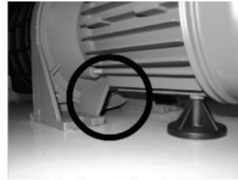
Contrôler régulièrement l'étanchéité! (Une fuite au niveau de la garniture mécanique peut provoquer des dommages importants!)
